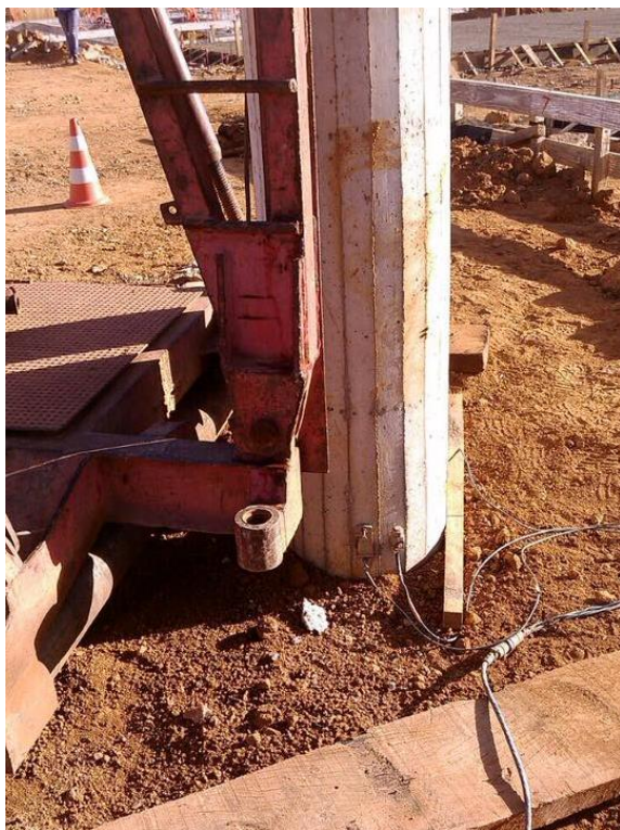
Figura 04- Uma estaca instrumentada com acelerômetro e transdutor de deformação. Obra da AP&L Geotecnia e Fundações.
